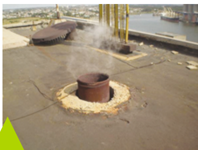
Salida de vapor de la caldera sin silenciador.
