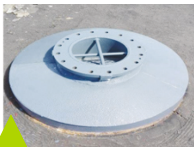
Nueva salida de vapor de la caldera con silenciador.
