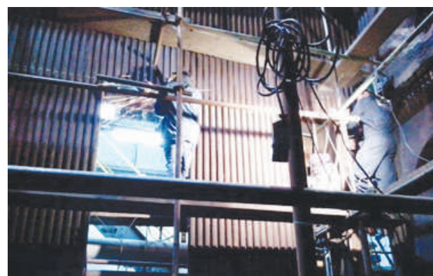
▲ Reparación de las paredes de hogar en la caldera 8. El vapor de estas calderas sale a una presión de 80kg/cm 2 y a una temperatura de 500° C.
