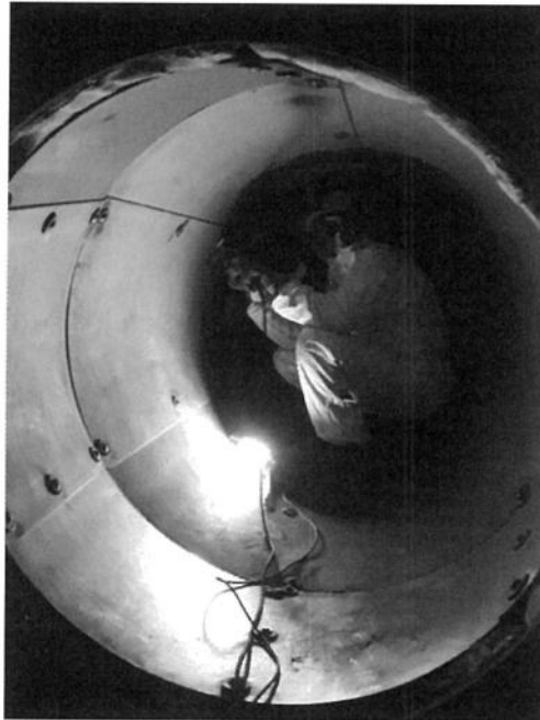
Soldadura interna de juntas de ducto de escape y túnel de carga.
