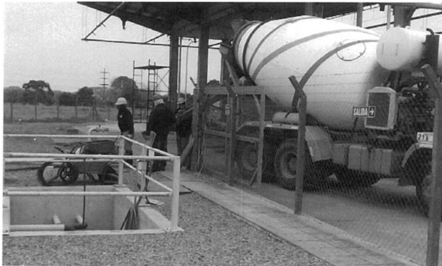
Llenado platea filtros gasoil Isla de descarga
