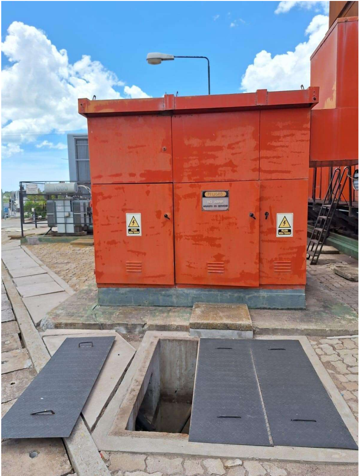
Celdas MT 13,2 kV turbina TG14
